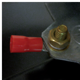
Toma de tierra
